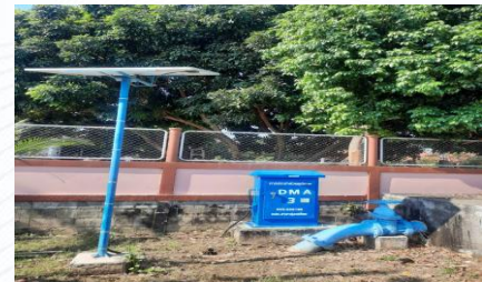
การใช้งาน Solar Cell ในระบบบิโครเอเจอร์จ่ายน้ำ
