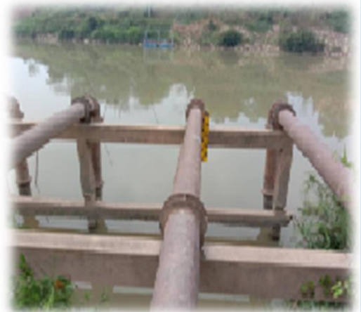
จุดสูบน้ำดิบแรงต่ำแม่ข่าย(แม่น้ำยม)
